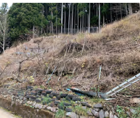
土砂崩落箇所
