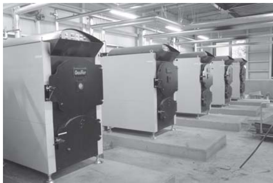
薪ボイラー機5台設置
