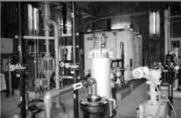
建物の中の浄水設備
